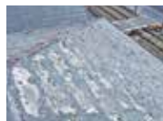
塗装の剥がれ
