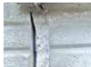
シーリング断裂
